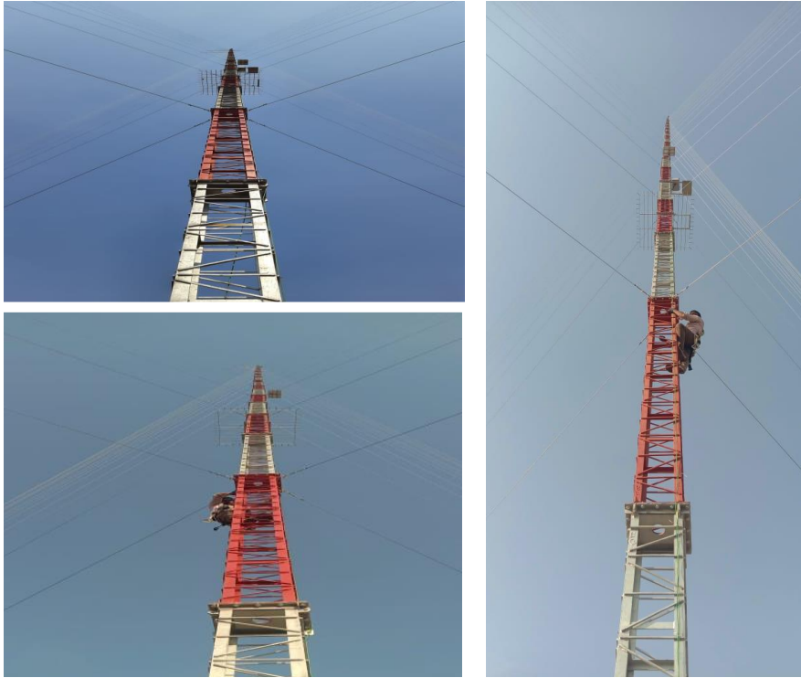
150Mtrs Mast Andra Pradesh - NREDCAP
